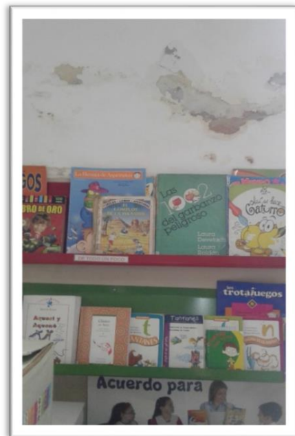
Manchas de humedad. Comparte pared con baños.
