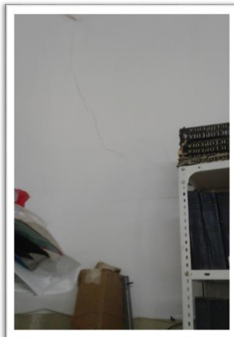
Grieta en la pared que no fue aún reparada
