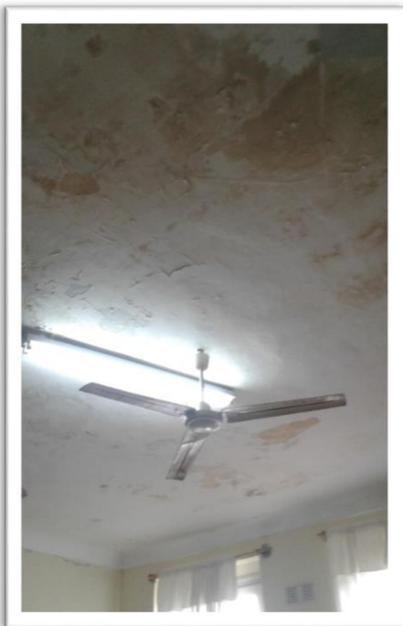
Cielorraso cubierto de humedad producto de la pérdida de un tanque agua
