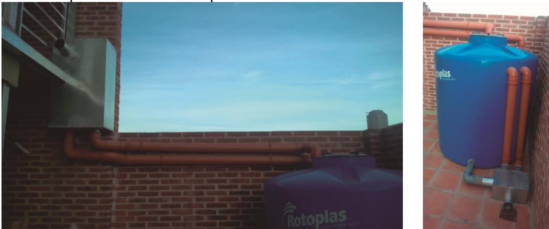
Fig. 1. Dispositivo instalado en edificio Güemes esquina Córdoba – Ciudad de Santa Fe
