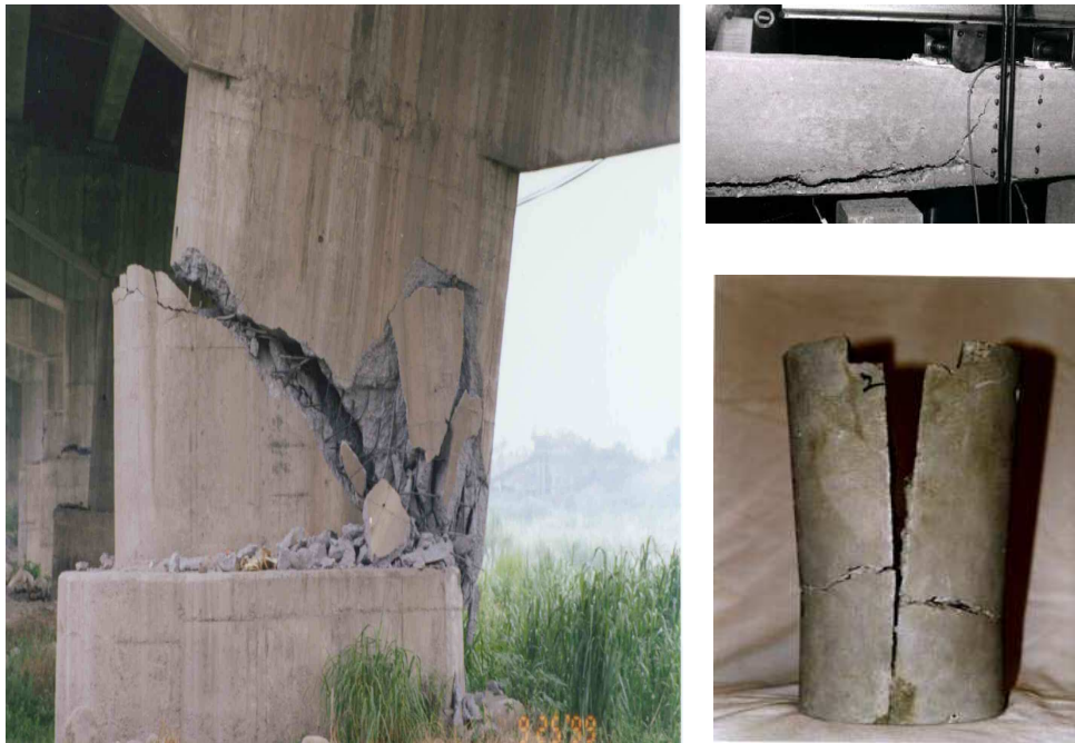
Figura 1.1: Fisuras y grietas en elementos de hormigón.
