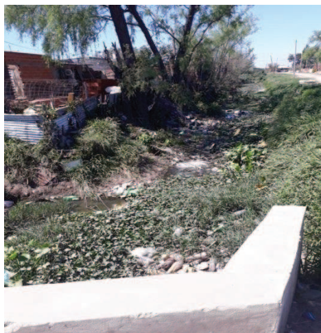
Fuente: Elaboración Propia Desagüe a cielo abierto calle Roberto Galarza
