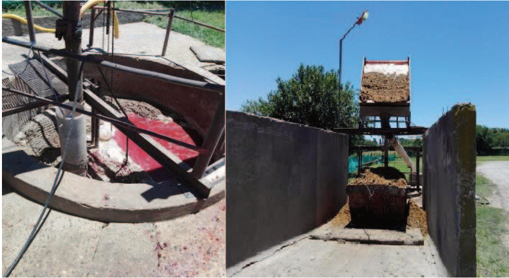
Foto 6: Pozo ecualizador, bomba de elevación y zaranda estática
