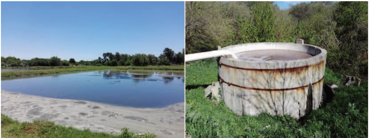
Foto 9: Lagunas anaeróbicas y lecho percolador.
