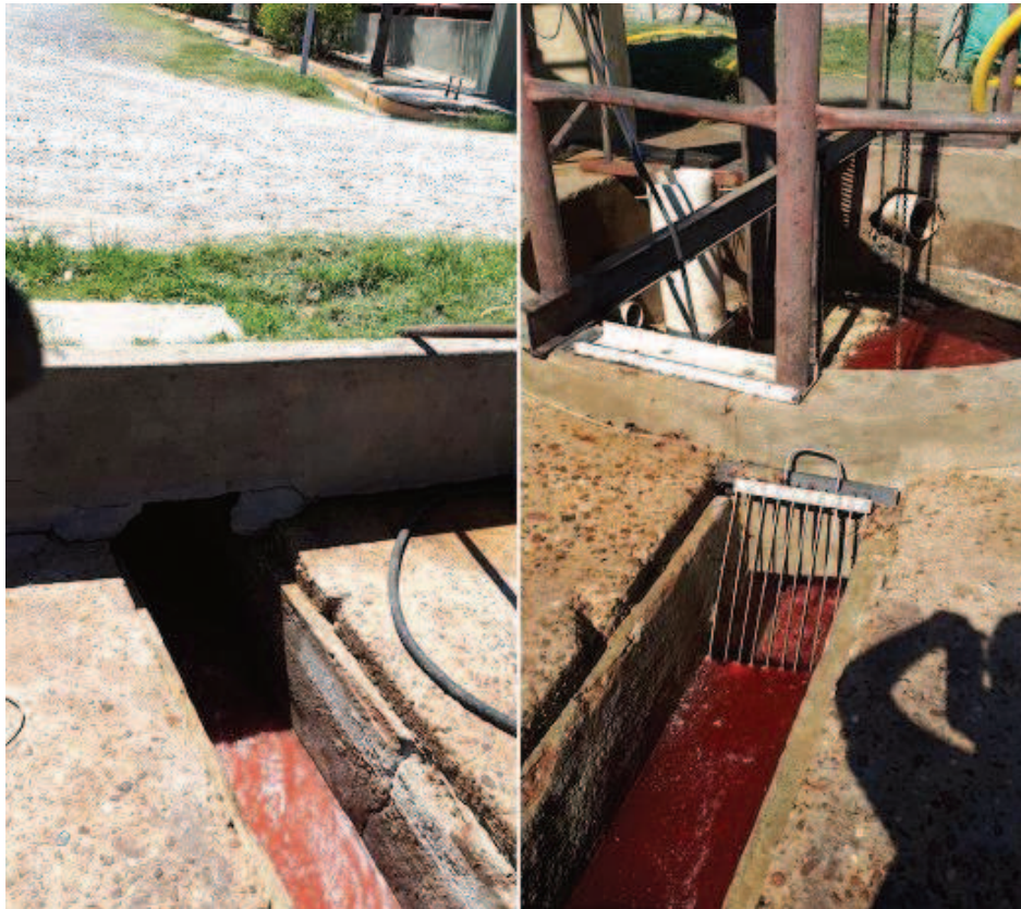
Foto 5: Canal de ingreso y reja de pre-tratamiento
