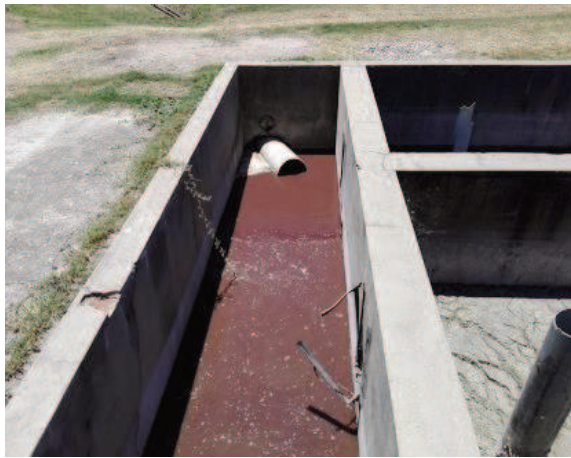
Sitio 3 (M3): Salida del sistema de tratamiento primario Coord. S 31°49'27", W 60°31'39"
