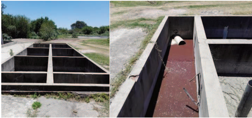
Foto 8: Segunda etapa de sedimentación, salida del tratamiento primario.
