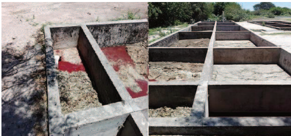
Foto 7: Ingreso al tratamiento primario, primera etapa de sedimentación.
