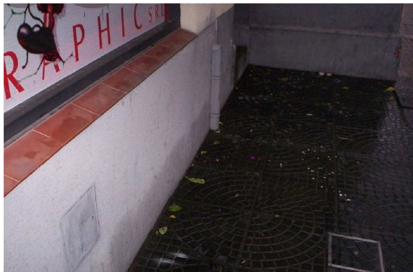
Figura 5.23: Rastro de una crecida sobre el frente de un local comercial.
