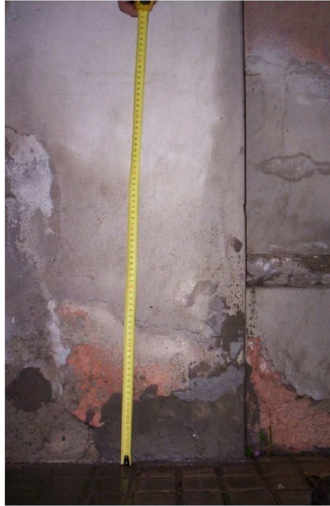
Figura 5.22: Medición del rastro del nivel máximo de una crecida sobre una pared, con una altura sobre la vereda de aproximadamente de 0.50 m.
