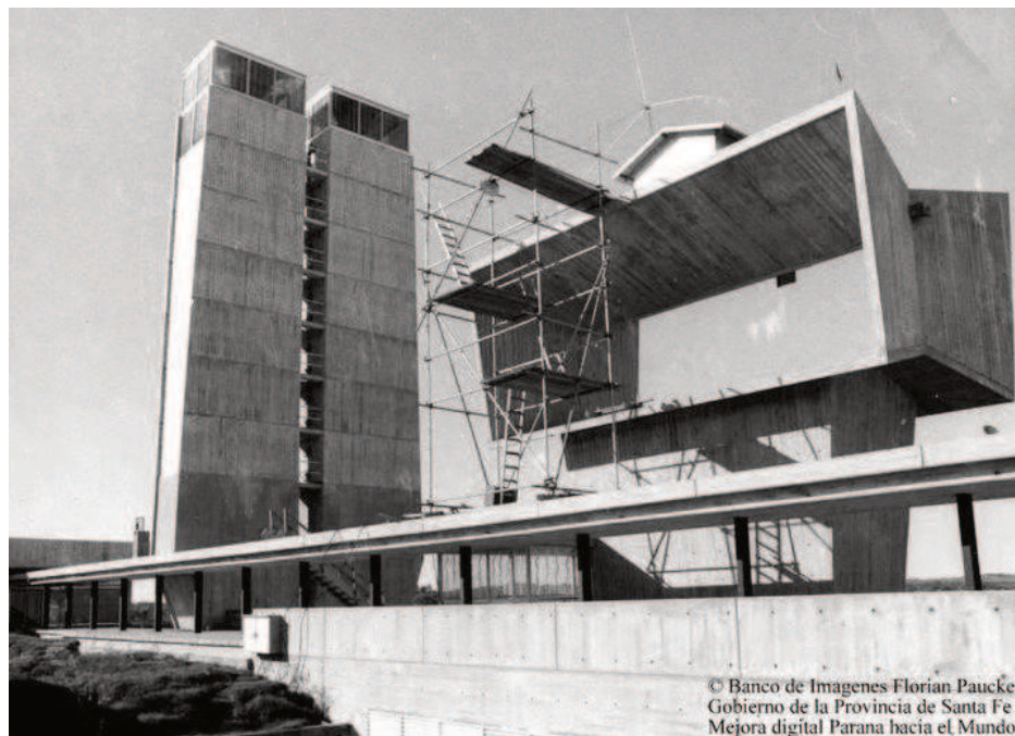
Figura 2: Construcción de las chimeneas del Túnel Subfluvial. Fuente: Banco de imágenes "Florian Paucke". Recuperado de:
